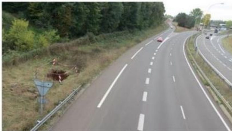
A deux pas de la chaussée de l'A320, à hauteur de Rosbruck, le sol s'est affaissé, laissant une impressionnante cavité. Selon toute vraisemblance, une conséquence de plus de l'exploitation minière. Photo M.L.
