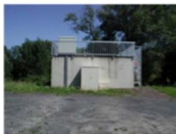
Illustration 38 - Le poste anti-crues de Rosbruck.
